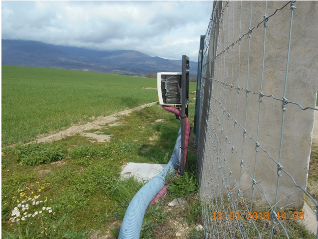
Línea subterránea de baja tensión
