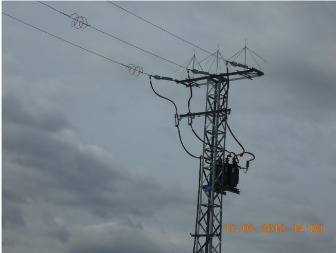
Nuevo apoyo con transformador
