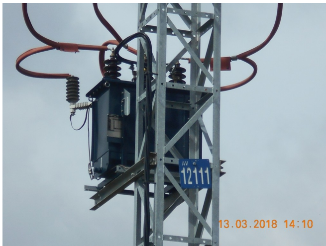
Transformador y número del apoyo
